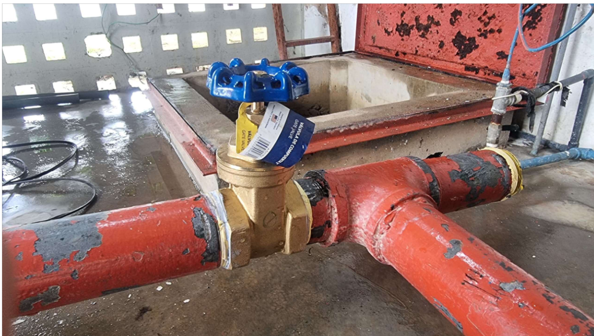
Anexo 15. Tubería que alimenta el agua de emergencia de los bomberos
