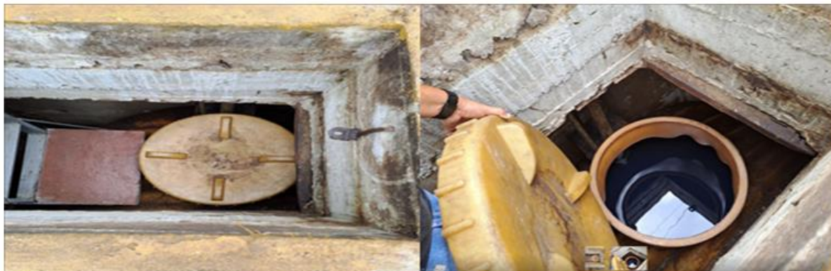
Figura 2 Vista de la boca de suministro del tanque de almacenamiento de combustible Diésel en el IMV.
